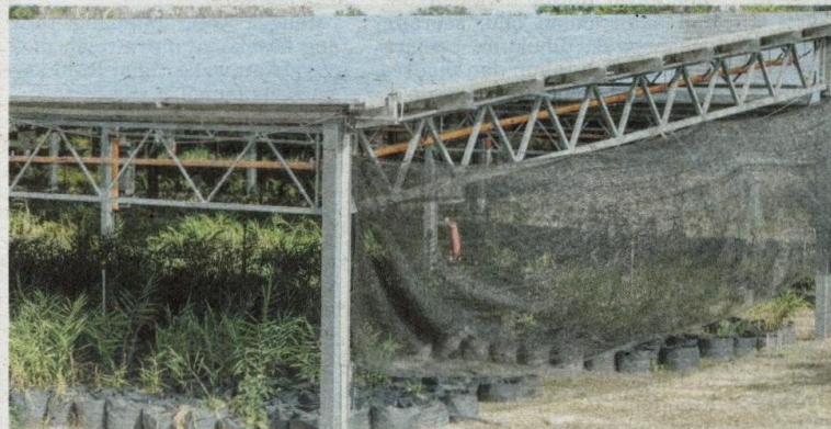
PANEL solar yang dipasang di Tapak Tenaga Solar MyAngkasa di Titi Akar, Pendang dengan pokok halia dijadikan tanaman sampingan untuk menambah pendapatan ahli.
